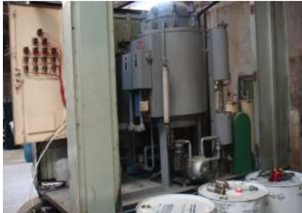
FIGURA 3.3 EQUIPO FILTRADOR DE ACEITE PARA LOS TRANSFORMADORES
