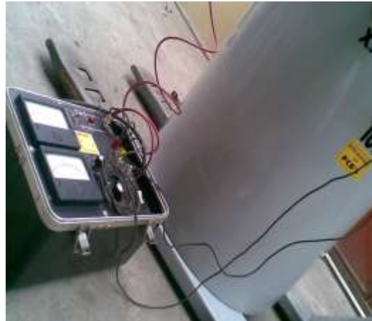
FIGURA 1.6 PRUEBA DE AISLAMIENTO DE UN TRANSFORMADOR CON MEGGER
