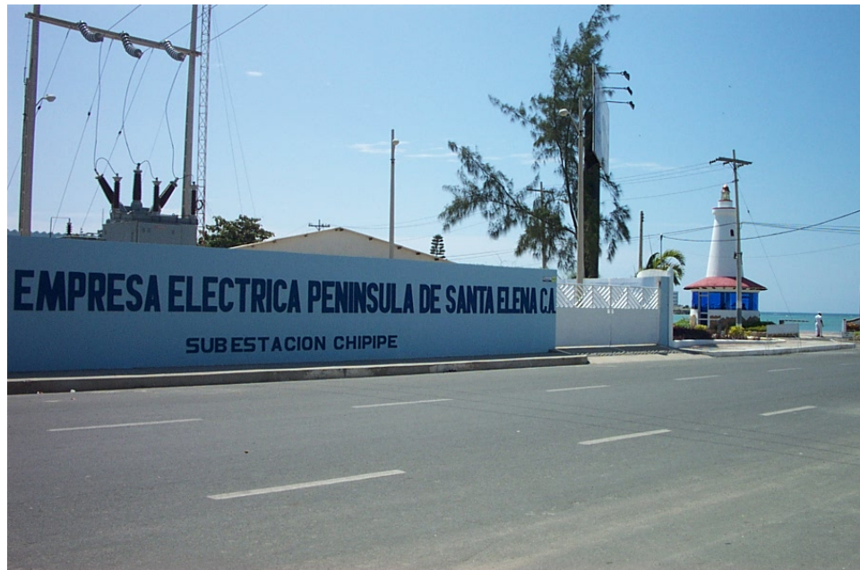
FIGURA 3.9. SUBESTACIÓN ELÉCTRICA CHIPIPE
