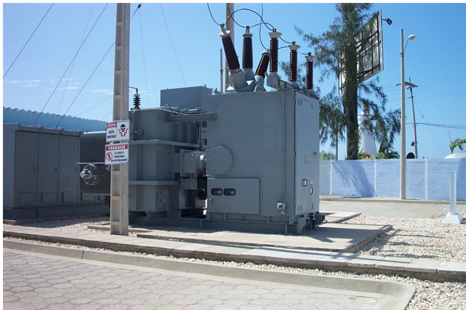
FIGURA 3.10. TRANSFORMADOR DE ALTA TENSIÓN ( 5 MVA)
