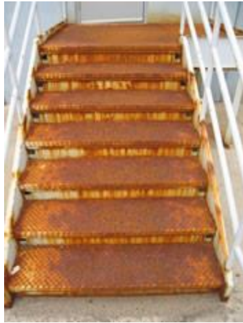
Superficie de escalera sin limpieza
