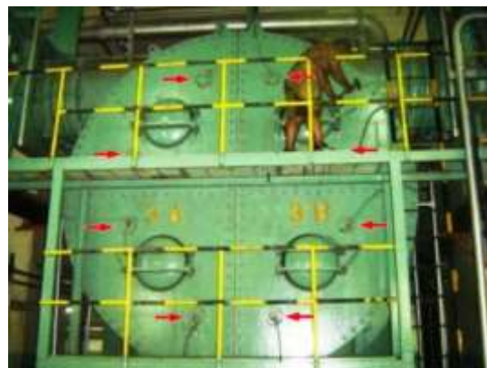
FIGURA 1.7 DISPOSICIÓN DE LOS ÁNODOS EN EL CONDENSADOR U3.
