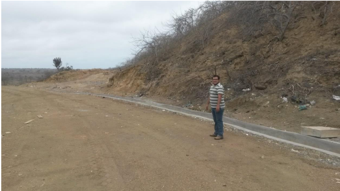
Fotografía 13. Canal para recolección de aguas superficiales del relleno sanitario en fase de cierre.
