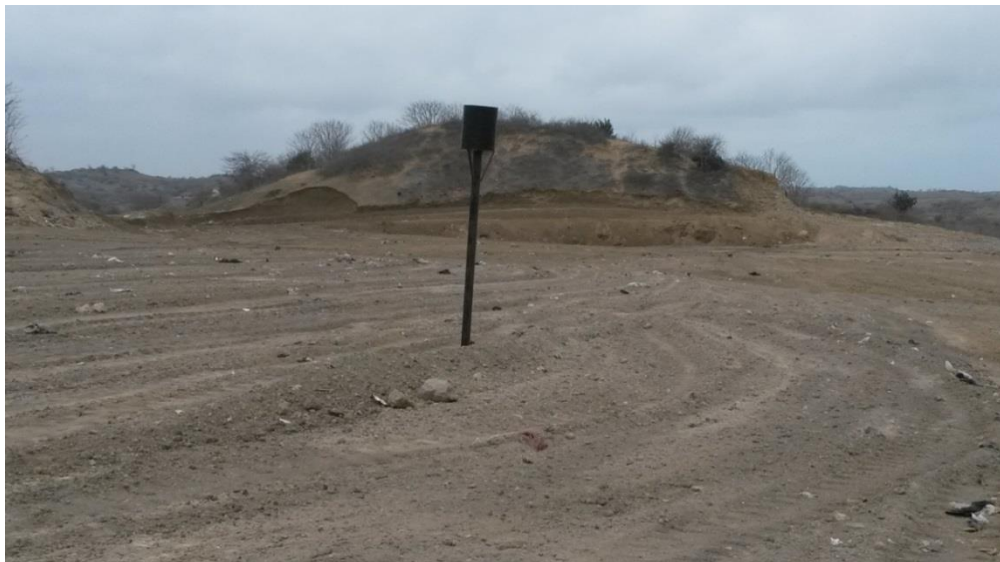
Fotografía 14 Salida de gases del relleno sanitario en fase de cierre.
