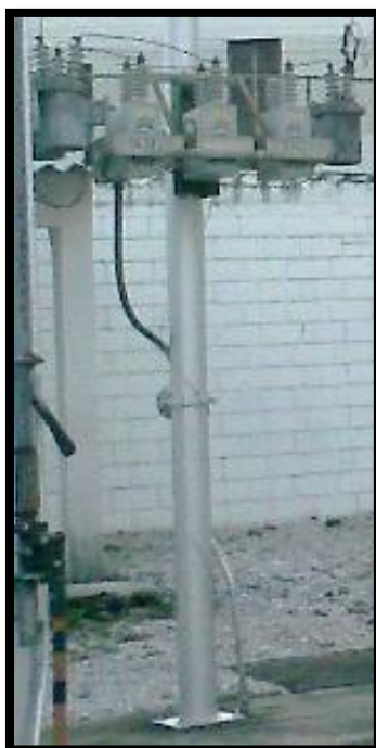
Figura 2.9: Banco de capacitores ubicado en la barra de 13.8 kV
