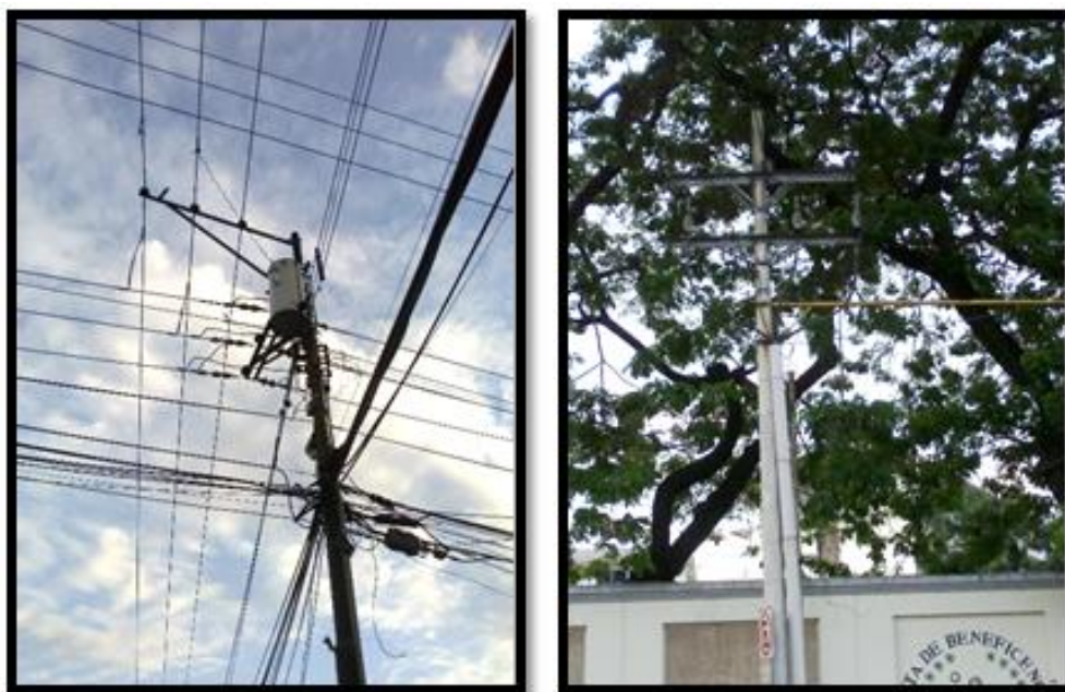
Figura 2.19: Estado actual de las redes de media tensión de la subestación Bien público.
