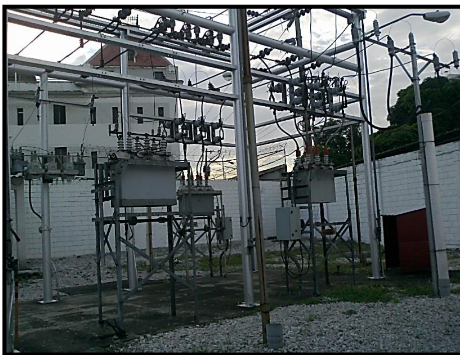
Figura 2.8: Patio de 13.8 kV de la subestación Bien Público.
