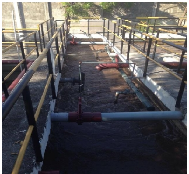
Digestor de lodos
