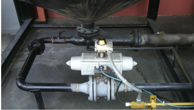
Foto 1 Electroválvula tanque H5 Fuente: Planta Manufactura
