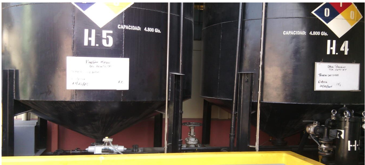
Foto 3 Tanques Pulmón H4-H5 Fuente: Planta Manufactura
