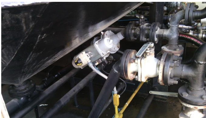
Foto 2 Electroválvula tanque H4 Fuente: Planta Manufactura
