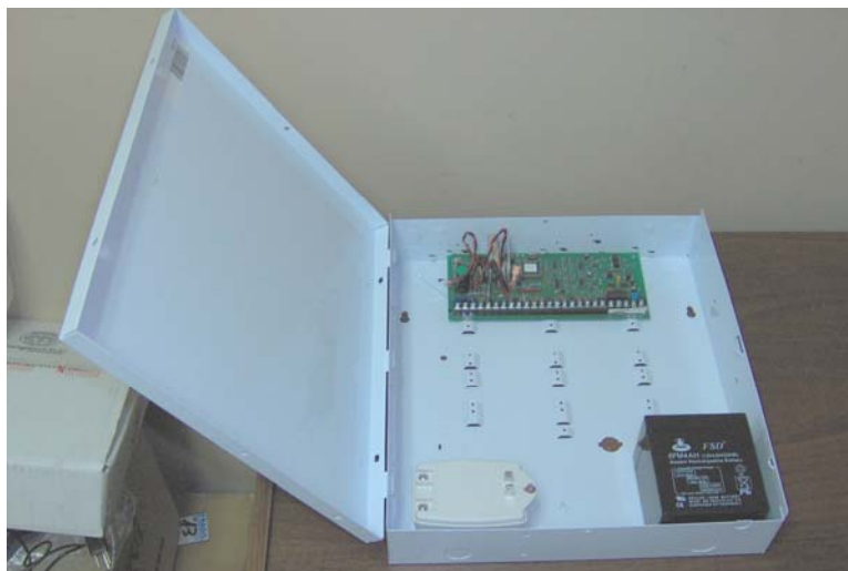
FIG. 4.4 Panel de Control de alarmas
