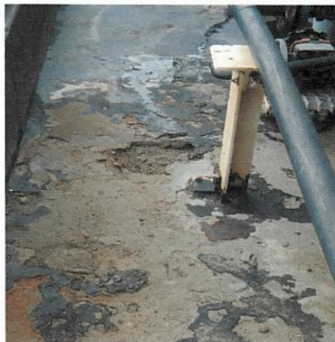
Figura No 2.5 DETERIODO DEL SUELO, (DERRAME DE HIPOCLORHITO).
