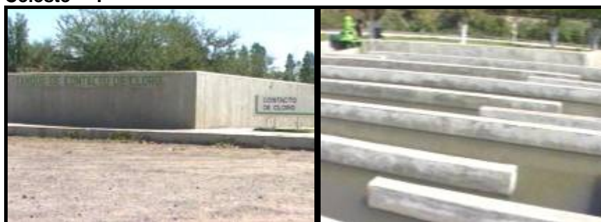
Figura 1.9 Unidad de Cloración instalada en un Sistema de Tratamiento de Aguas Residuales de la ciudad de México (19) .
