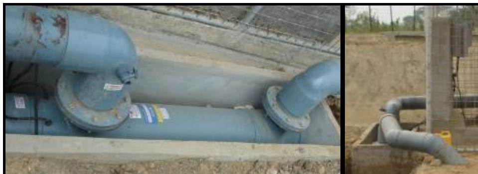
Figura 2.9 Construcción de la caja e Instalación del equipo de Desinfección de Rayos Ultravioleta (75) .
