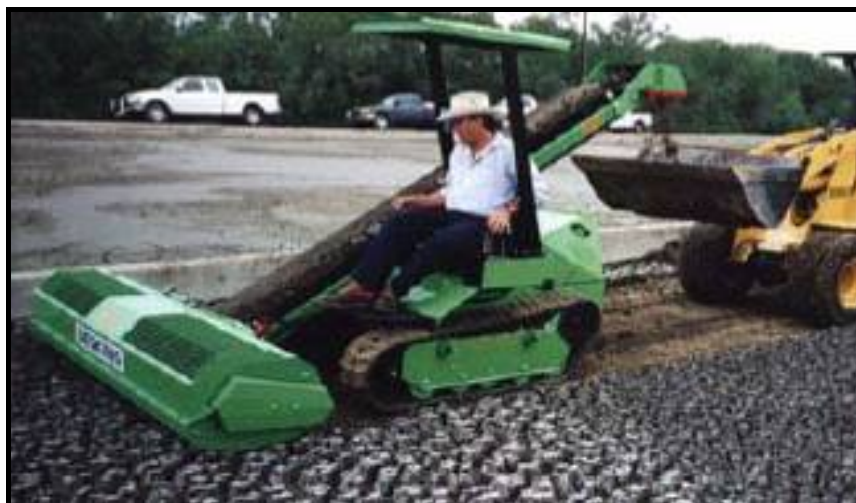
Figura 1.7 Lecho de secado de pavimento: Remoción del lodo para tratamiento (16) .
