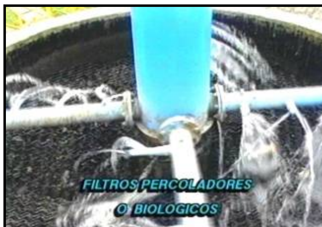
Figura 1.14 Tratamiento secundario: Filtros Percoladores Biológicos (26) .
