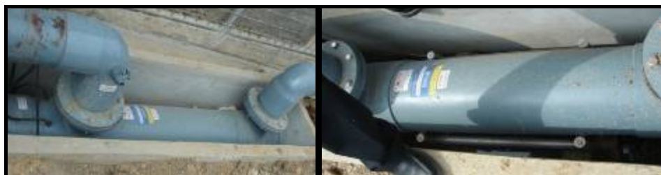
Figura 1.8 Unidad de desinfección de Rayos Ultra Violeta instalada en el Sistema de Tratamiento de Aguas Residuales de la Urbanización Ciudad Celeste (18) .
