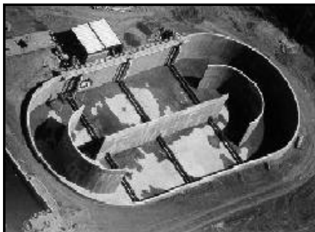
Figura 1.12 Tratamiento secundario: Zanjas de Oxidación (24) .
