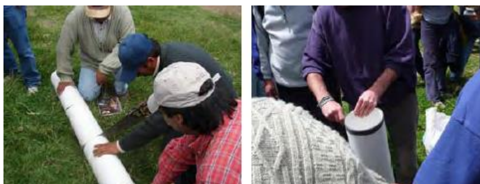
Figura 30. Tubería de PVC para entrada y salida
