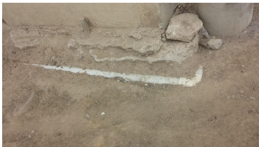
Fotografía 1. Mala Conexión de una red Tomada por el autor
