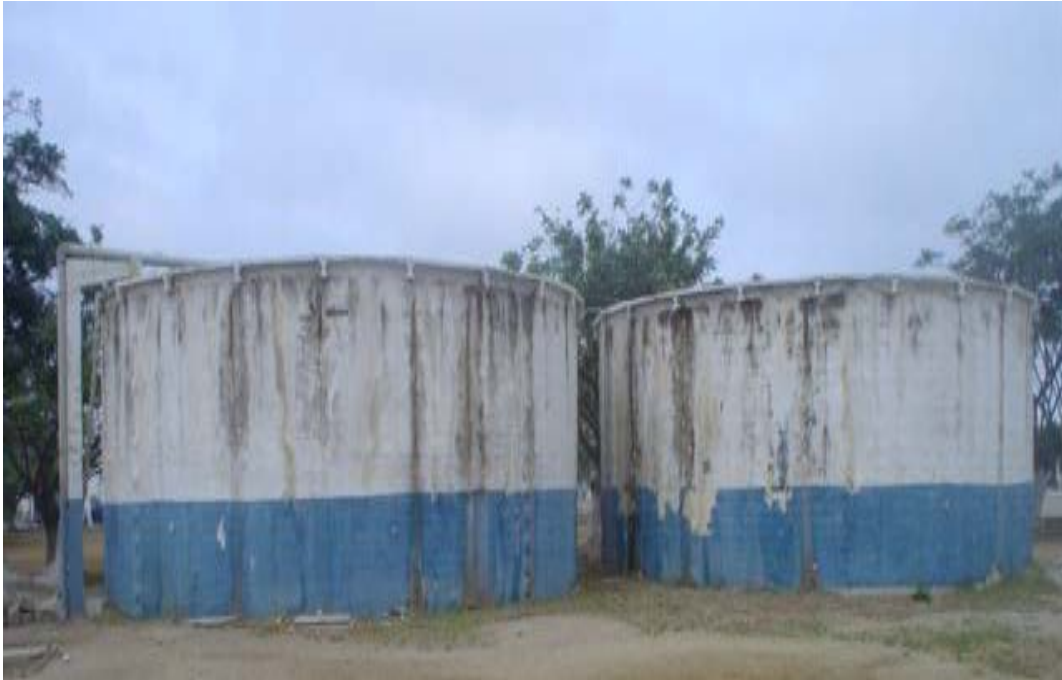
FIGURA 1.6 TANQUES CILÍNDRICOS DE ALMACENAMIENTO
