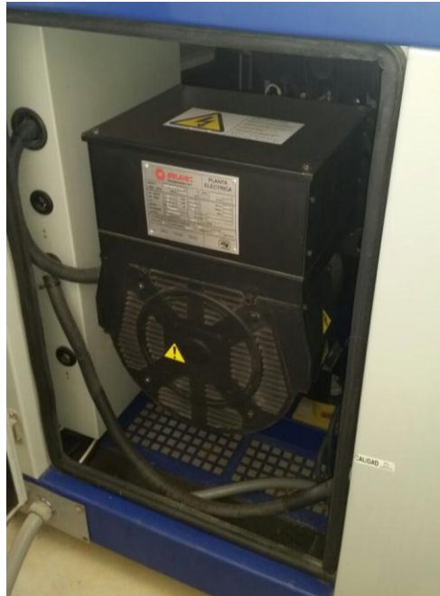
Figura 2.29: Instalación real de Generador Eléctrico 25KVA en RBS Fuente: Los Autores
