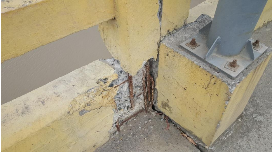
Fotografía 4.29: Estado actual, barandas peatonales. Fuente: Autores.
