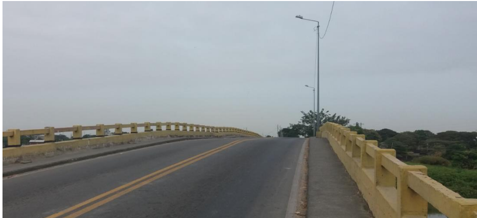
Fotografía 4.16: Estado actual del tablero. Deformación longitudinal. Fuente: Autores.
