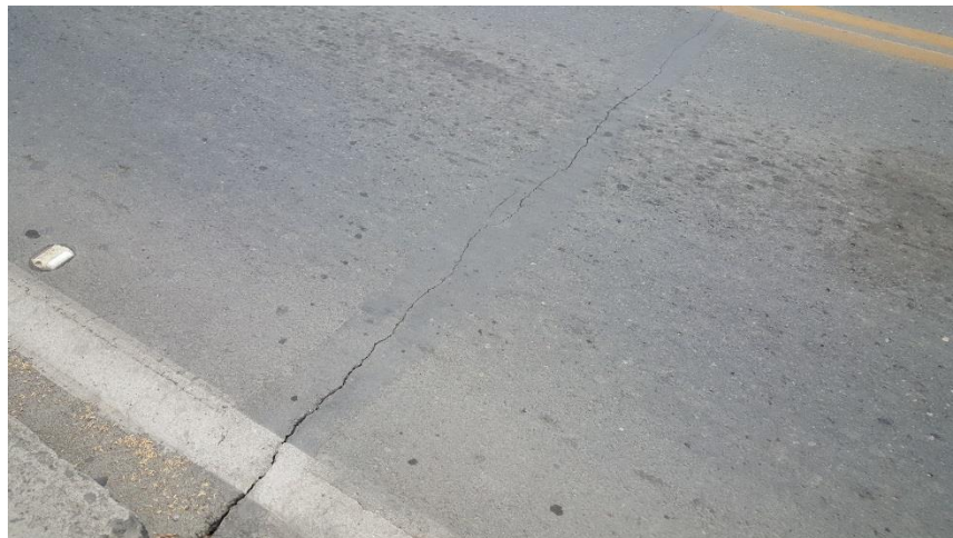
Fotografía 4.17: Fisuras en carpeta asfáltica. Fuente: Autores.
