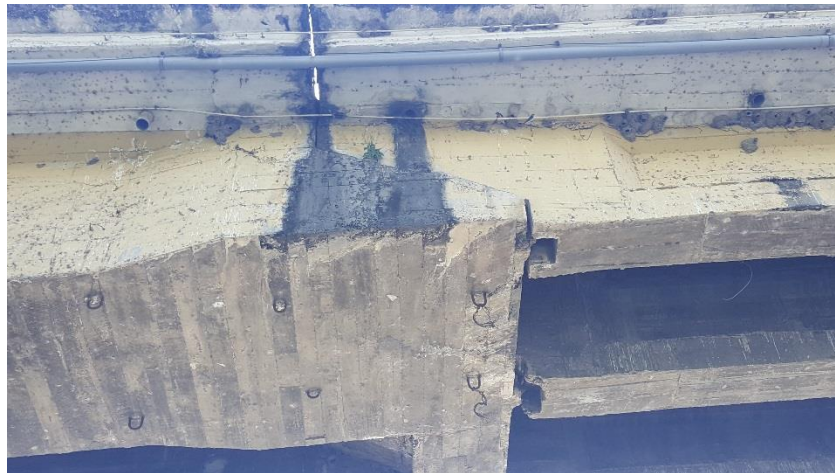
Fotografía 4.38: Efectos del sismo de Pedernales en las vigas. Fuente: Autores.
