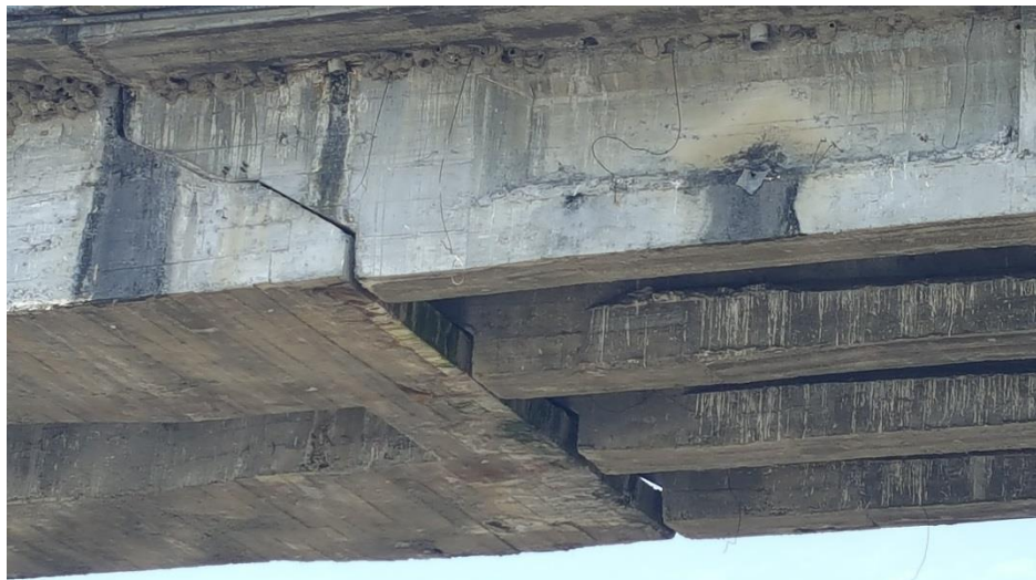
Fotografía 4.23: Estado actual, desplazamiento lateral en vigas preforzadas del tramo 3. Fuente: Autores.
