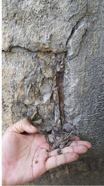
Fotografía 4.32: Estado actual, varillas expuestas en el estribo E1. Fuente: Autores.
