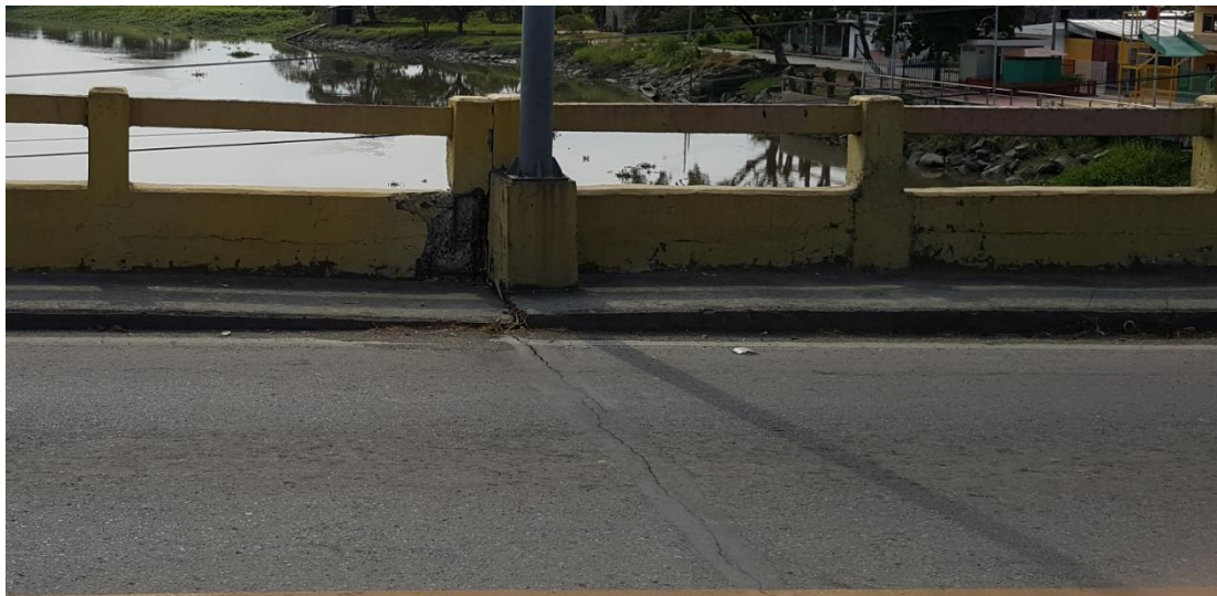
Fotografía 4.27: Estado actual, junta transversal en tramo 3. Fuente: Autores.
