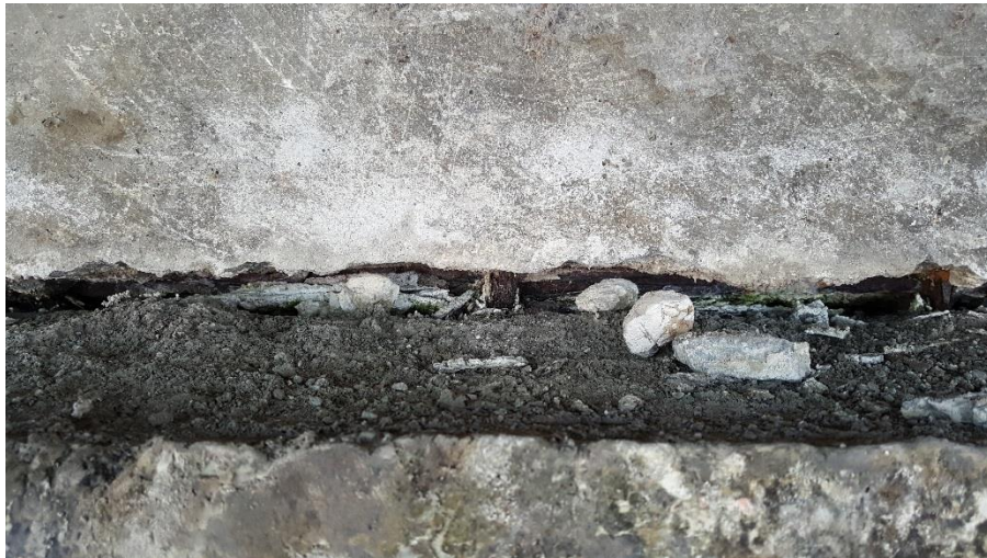
Fotografía 4.33: Estado actual, varillas expuestas y relleno no contenido en el estribo E2. Fuente: Autores.
