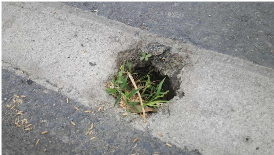
Fotografía 4.31: Estado actual, desagües con maleza.
