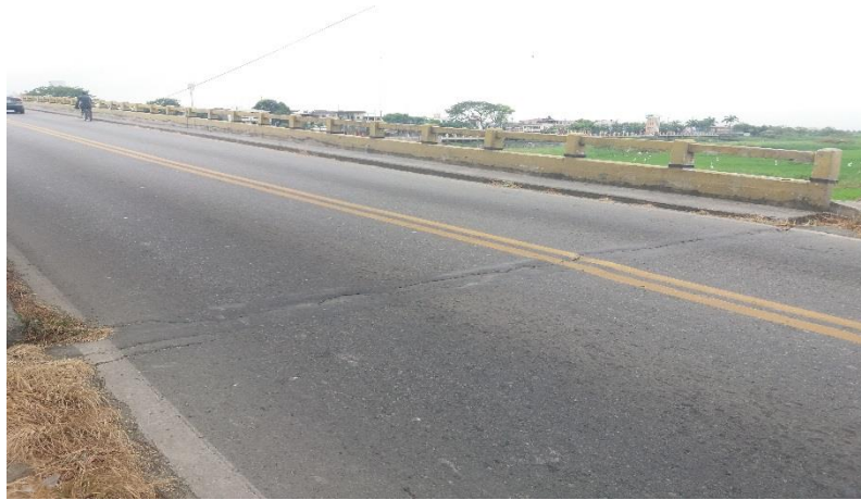
Fotografía 4.28: Estado actual, junta transversal en acceso al tramo 2. Fuente: Autores.
