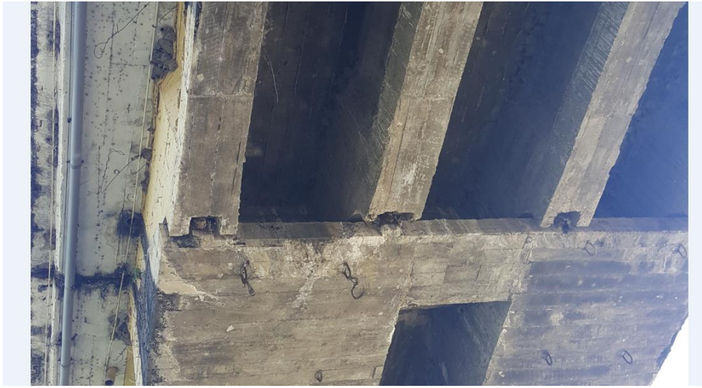
Fotografía 4.22: Estado actual, daño en vigas preforzadas tipo I del tramo 3. Fuente: Autores.
