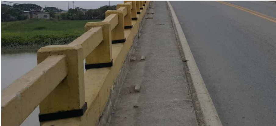
Fotografía 4.30: Estado actual, veredas peatonales.
