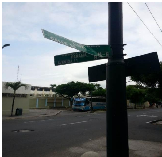
Fotografía 13 Calle Loja – Señalética en mal estado
