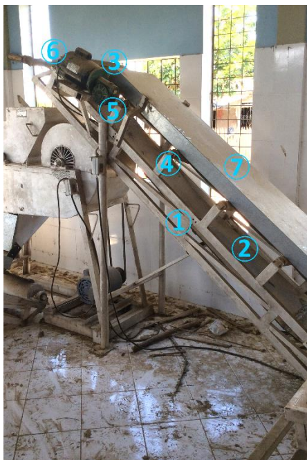
Figura 1.4 Estado actual de sistema de banda transportadora
