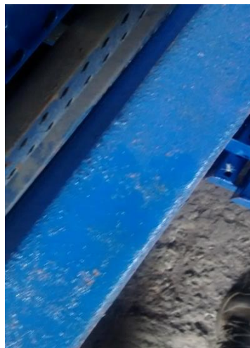
Figura 1-5 Erosión de la pintura por exceso de curado
