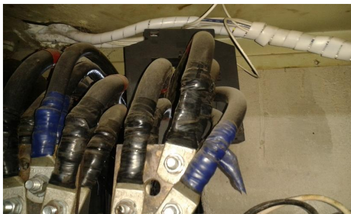
Figura 3.15. Conexión del Transformador de Corriente (TC)
