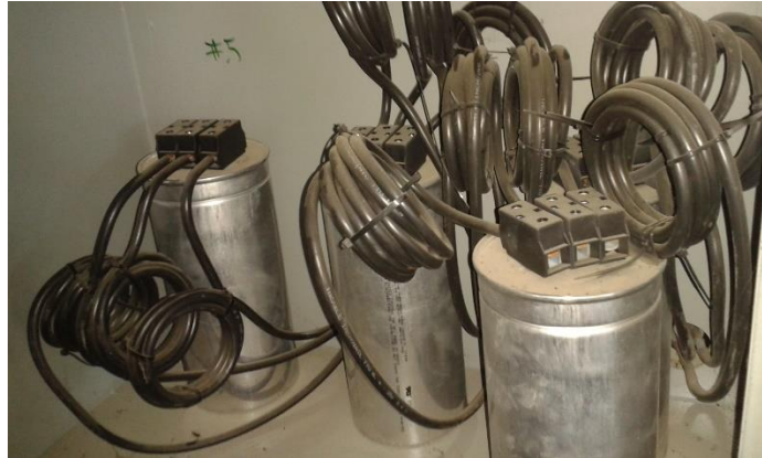
A7. Condensadores de 20 kVAr junto a los de 10 kVAr.
