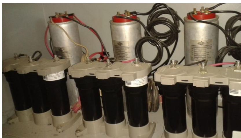
Figura 3.13: Grupo de condensadores de 30 kVAr.
