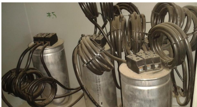
Figura 3.12: Grupo de condensadores de 50 kVAr.
