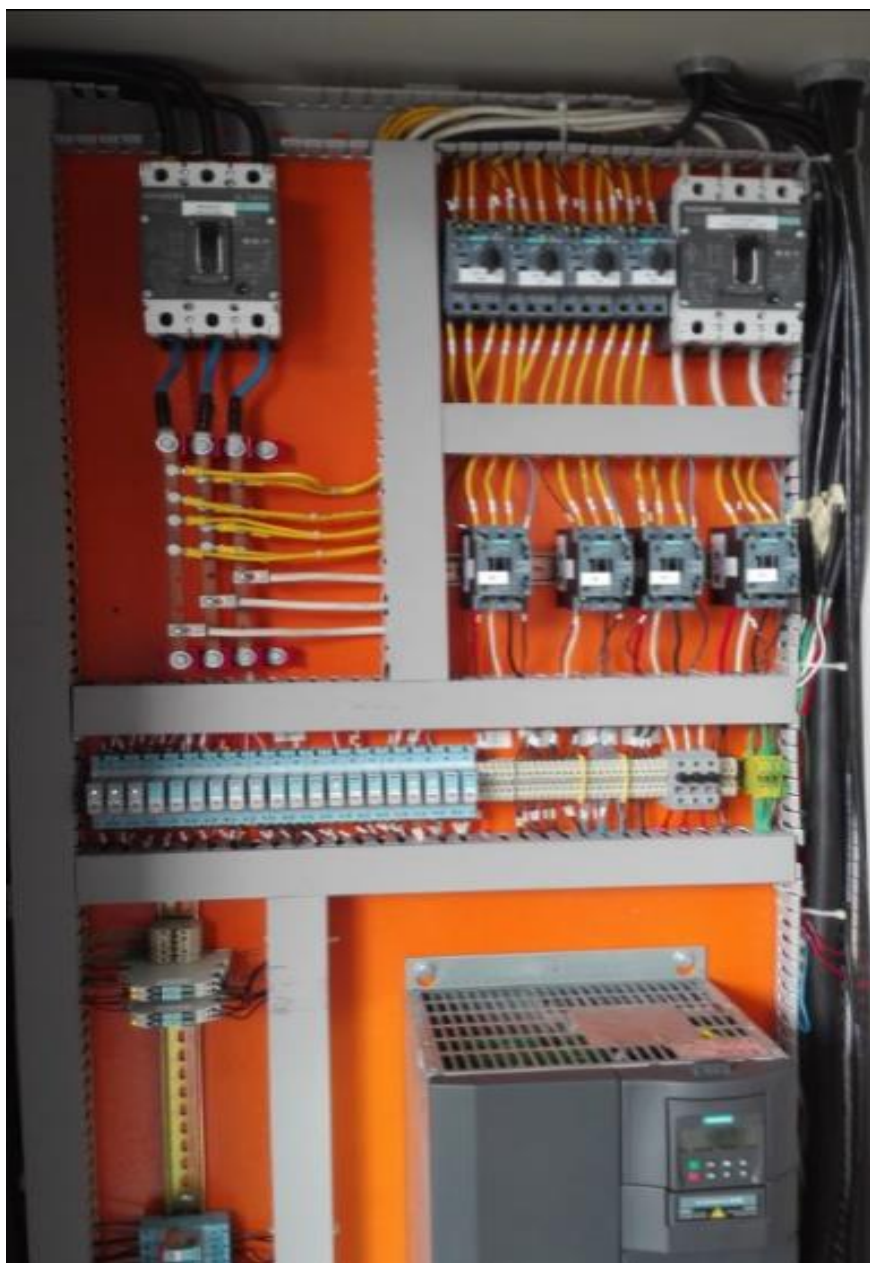
Figura 4.8: Tablero de Fuerza de control de bombas y ventilador
