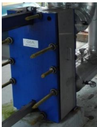
Figura 2.2: Intercambiador de placas
