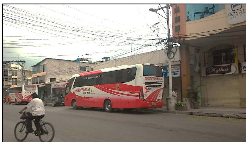
Figura 1.10: Cableado holgado cerca de un transporte interprovincial, calle Junín entre Sucre y Olmedo.
