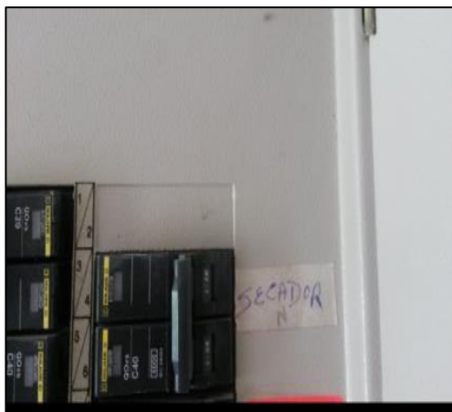
Figura A.4.3. Breaker General LOPU
