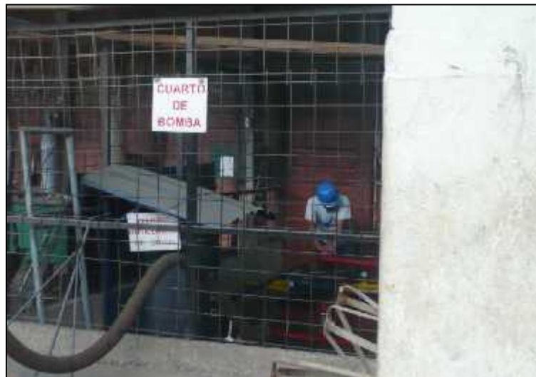
Figura 2.4. Señales de seguridad poco visibles
