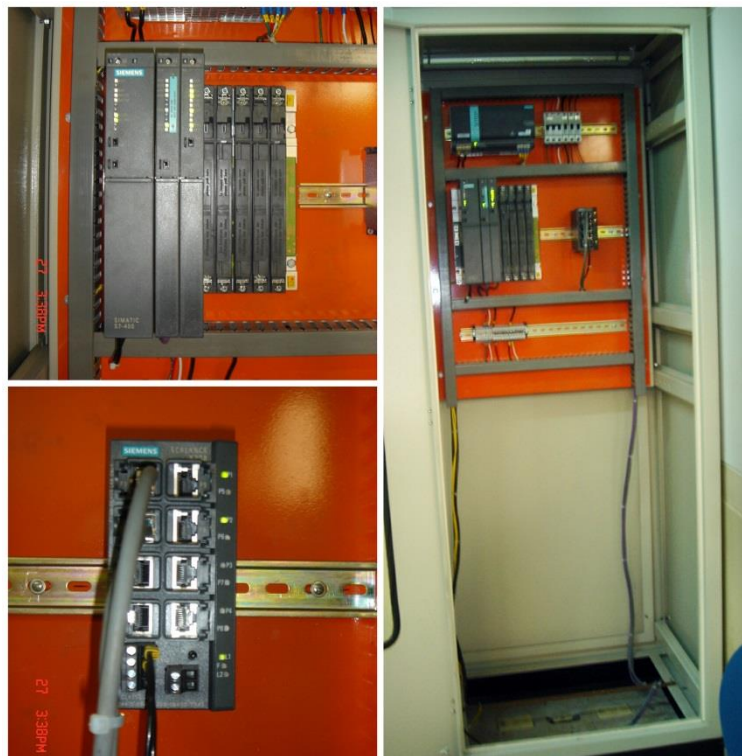
Figura 7: Tablero Unidad Central S7-400
