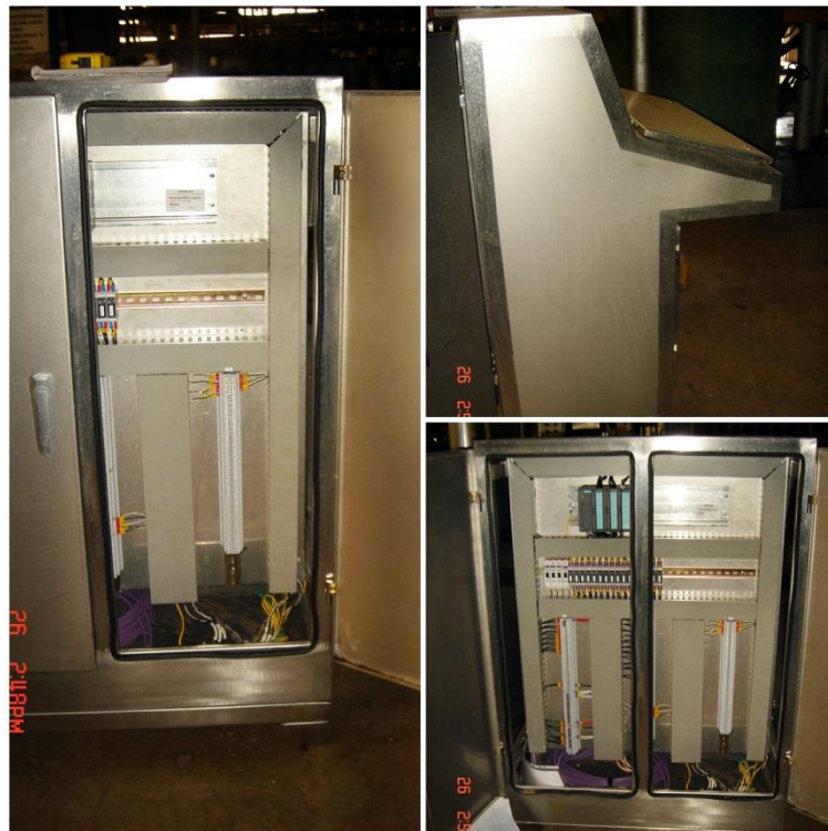
Figura 10: Pupitre de Estación de control en Hidropulper y Belpurgue.
