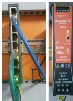
Figura 2.5: Switch y fuente de alimentación externa.
