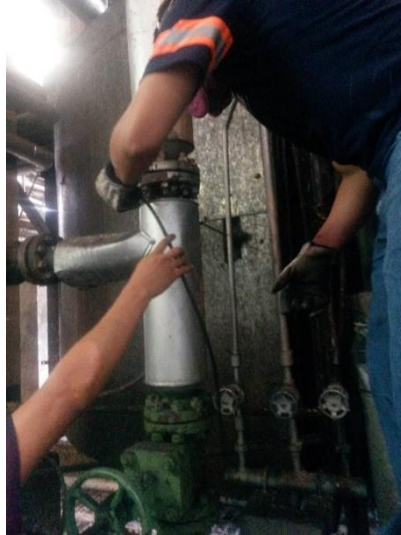
Figura C.1: Usos del Analizador de gases Testo, se está introduciendo la sonda en un orificio de la chimenea.
