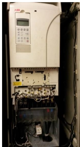
Figura 2.18: Variador de frecuencia.
