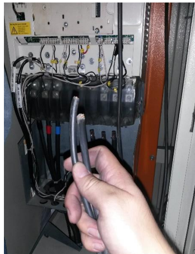
Figura C.2: Trabajo en planta, cableado desde la estación remota al variador de frecuencia.
