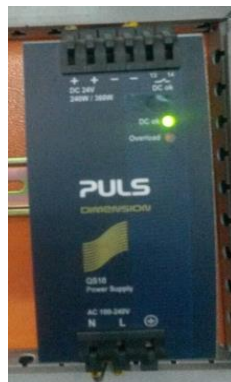
Figura 2.8: Fuente de alimentación que energiza la estación remota.
