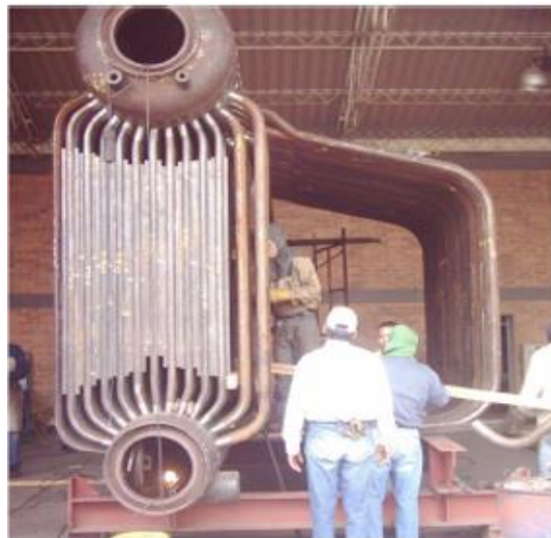
Figura 1.4: Vista Interior de una caldera Acuotubular tipo D.
