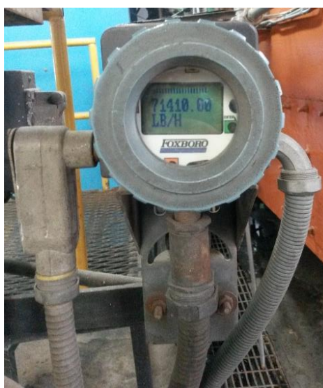
Figura 2.13: Transmisor de flujo de vapor.
