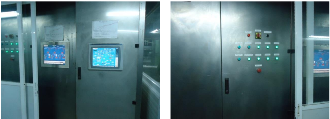
Figura #17: Tablero de control de quemadores y protecciones de caldera con pantallas táctiles
