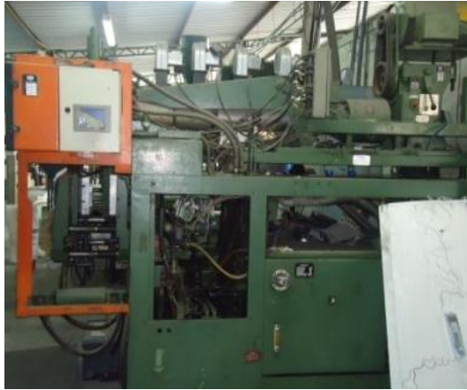
Maquinas sin cubierta protectora
