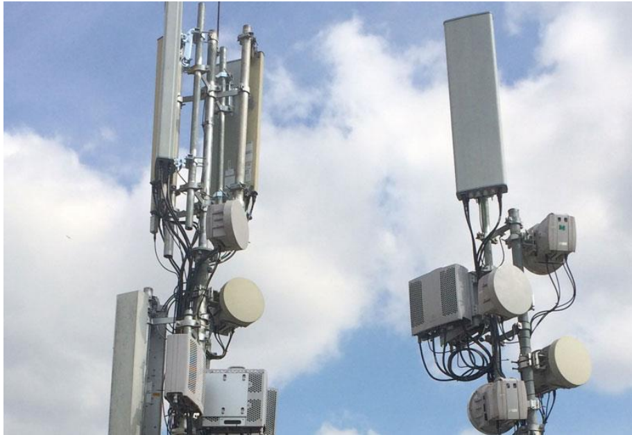
Figura 2.1: Diferentes antenas de estación de base
