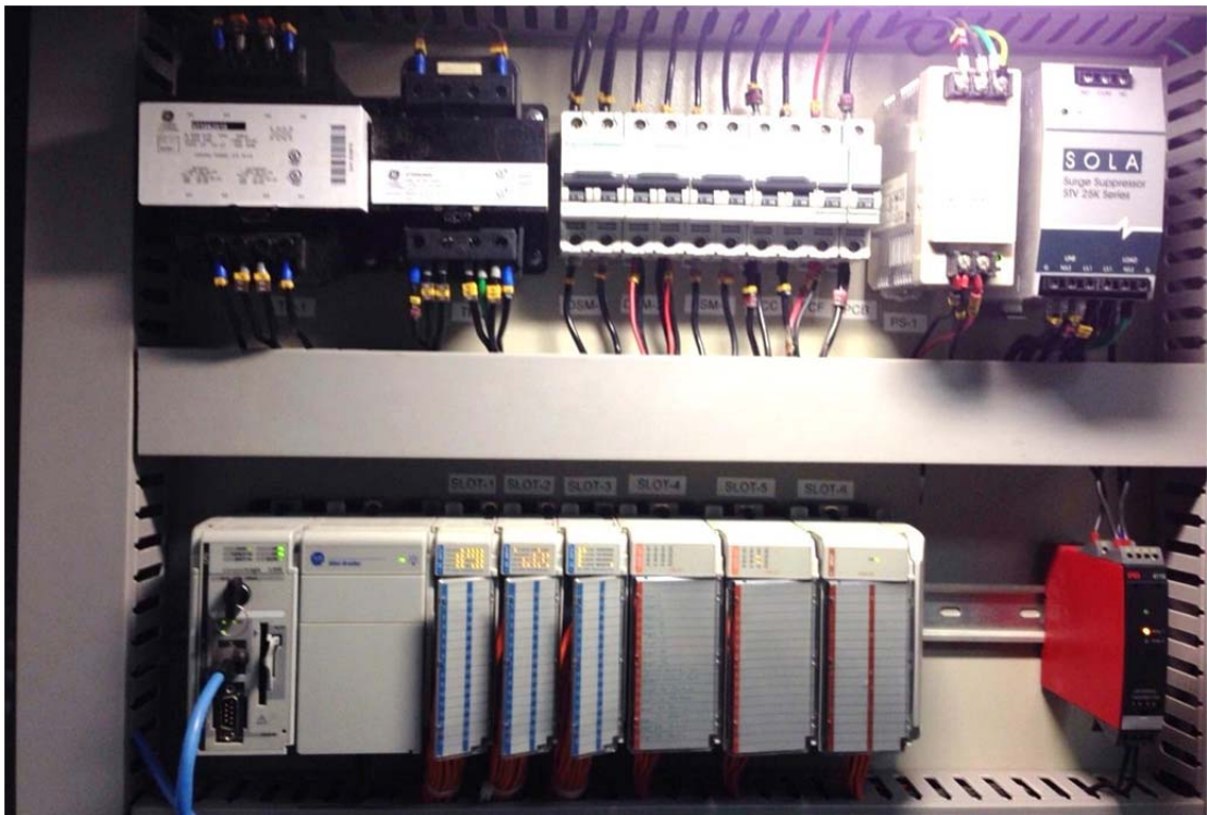
Figura 1.2: Rieles, canaletas, transformadores, supresor de pico, breaker y fuente de alimentación del tablero, PLC CompactLogix, módulos I/O
