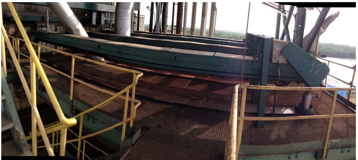
Soplador de caldera (SOBRECALENTADOR PRIMARIO)
