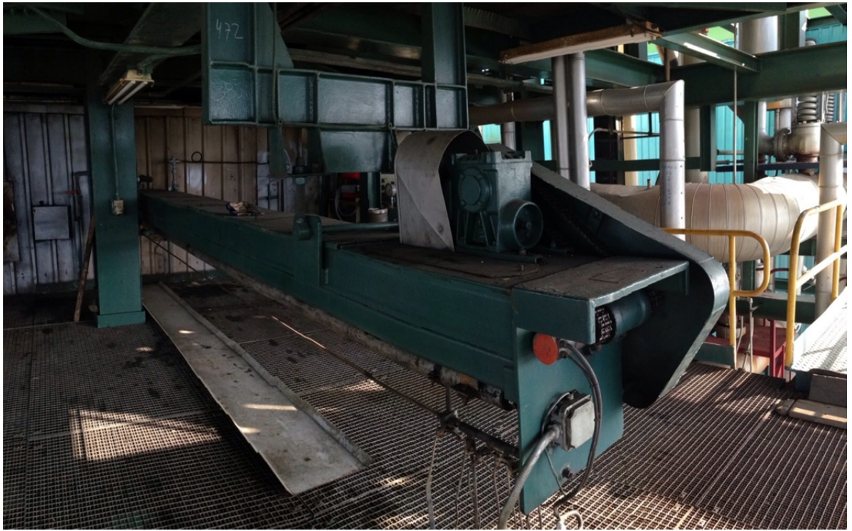
Soplador de caldera (SOBRECALENTADOR SECUNDARIO)
