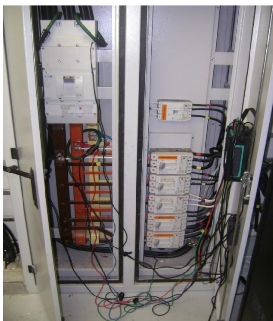
Figura 6.10 Tablero del UPS 460 V del CDI donde fue localizado el KYORITSU
