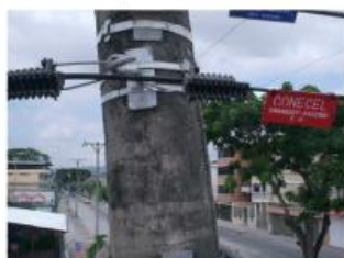
Montaje de F.O. en poste, con mordazas y correcto etiquetado
