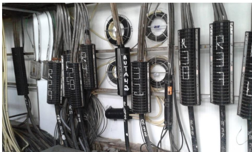
Figura 2.3: Galería de cables de la Central Norte CNT E.P.
