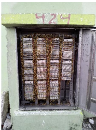
Figura 2.4: Armario de Distribución.
