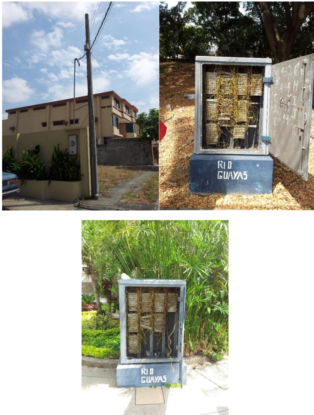
Figura 4.14: Inspección de la Urbanización Río Guayas
