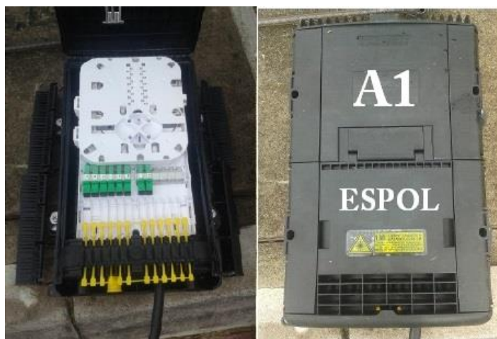
Figura 3.27: Fotos interna y externa de una NAP. [26]
