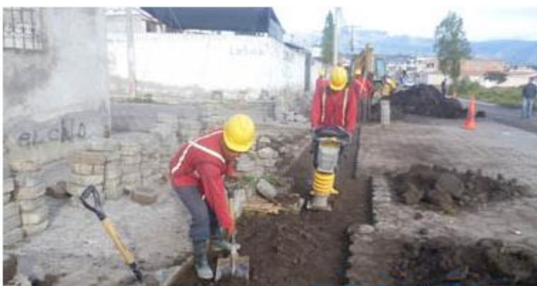
Figura 3.2: Infraestructura, Fibra óptica subterránea
