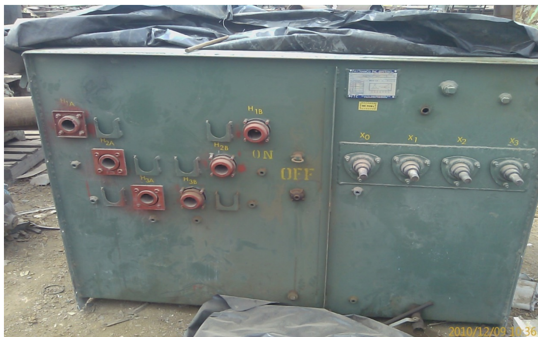
Fig. 2.6: Transformador 750 KVA usado, antes de mantenimiento
