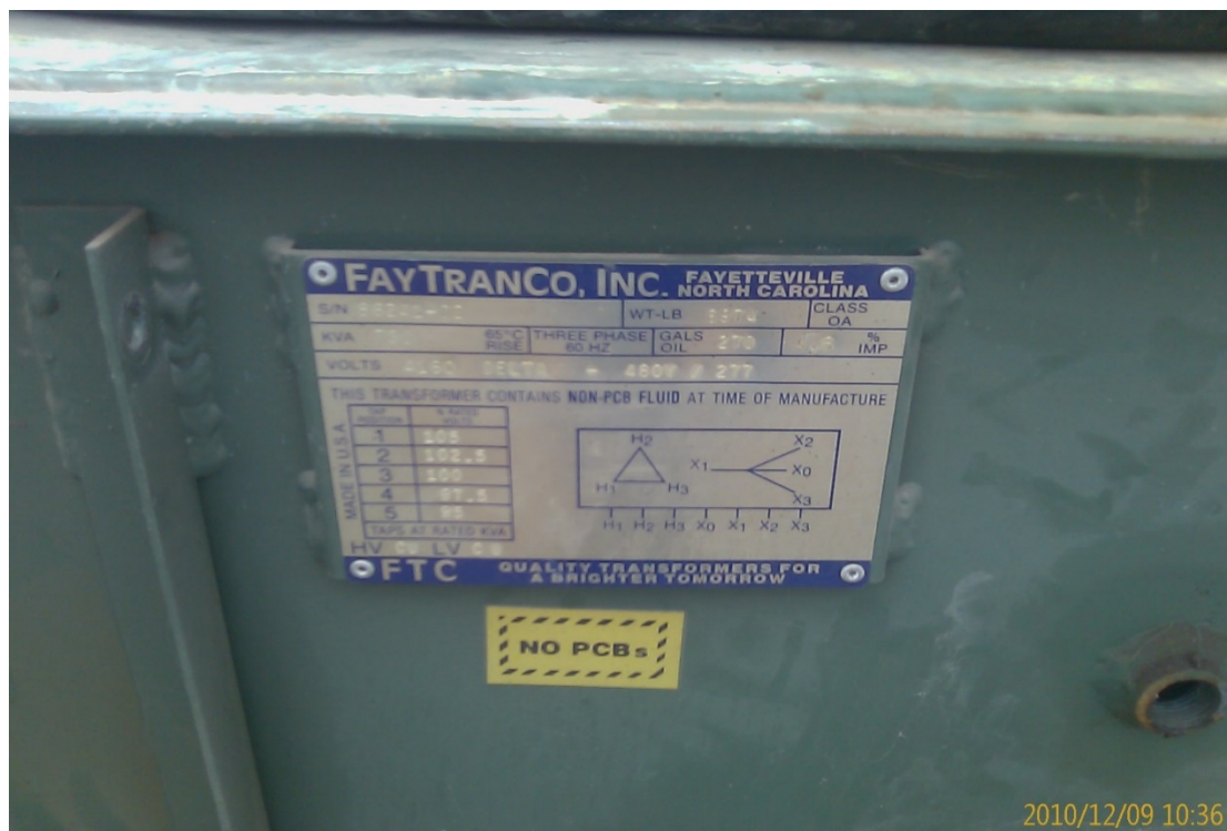
Fig. 2.5: Placa de transformador usado, antes de mantenimiento
