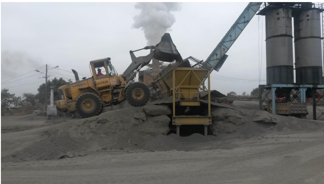
Figura 4.2. Planta de producción de asfalto convencional en funcionamiento, ubicada en cantera de Durán. Colocación del material pétreo en las tolvas. Fuente: Contreras, K., Delgado, A., 2017.
