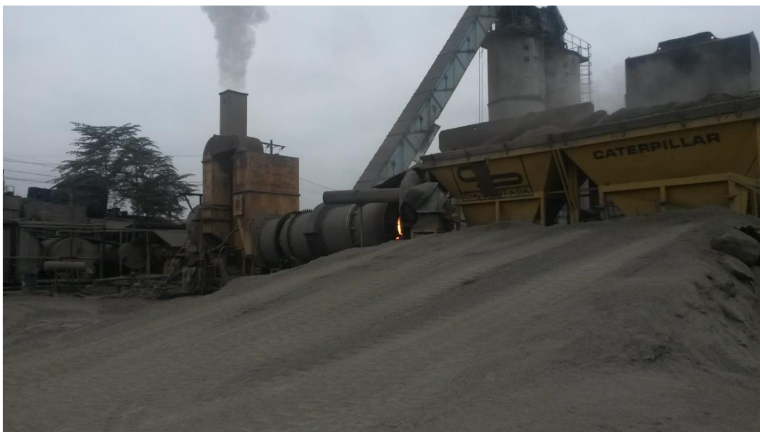
Figura 4.3. Planta de producción de asfalto convencional en funcionamiento, ubicada en cantera de Durán.
