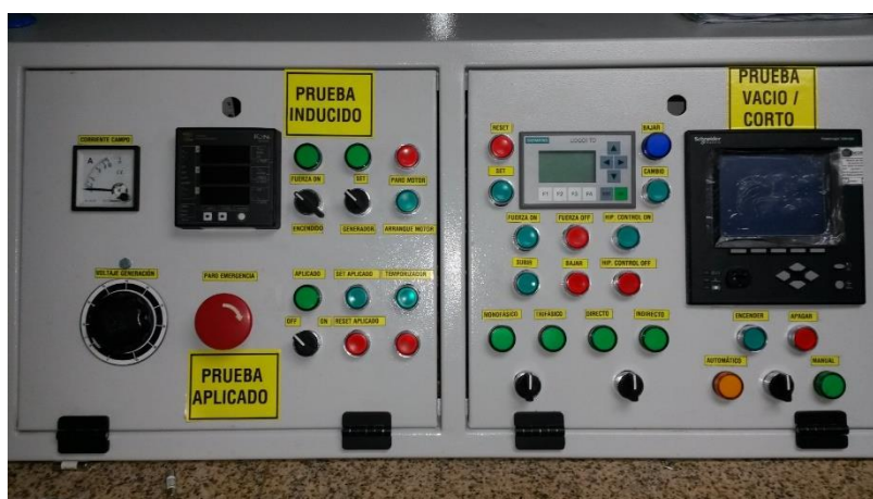
Figura 6.2. Tablero panel operador terminado.
