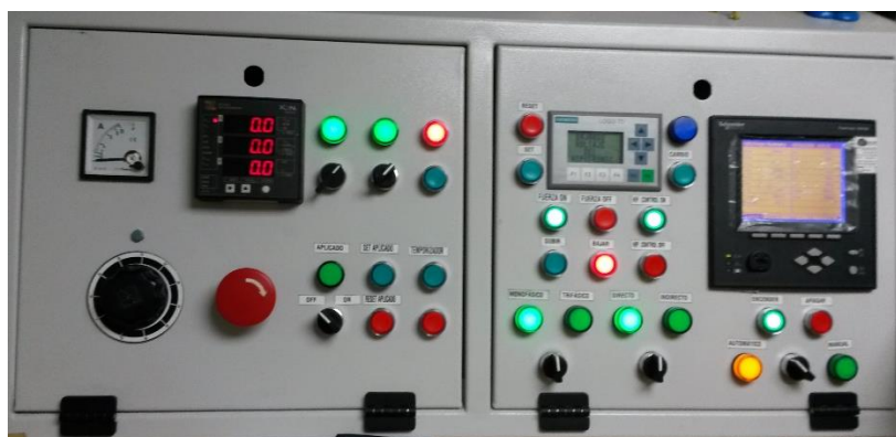
Figura 5.8. Panel de operador en espera.
