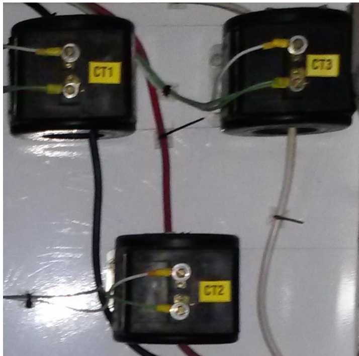
Figura 2.11. Transformadores de corriente.
