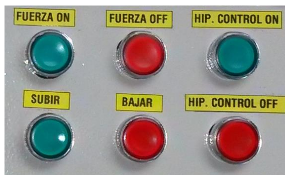
Figura 5.32. Control Manual Autotransformador Hipotronic.
