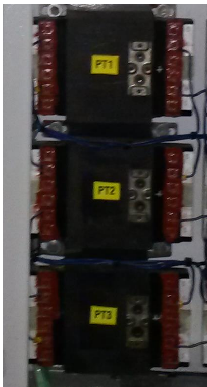
Figura 2.10. Transformadores de potencial.
