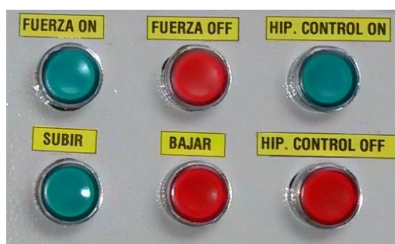
Figura 5.16. Control Manual Autotransformador Hipotronic.
