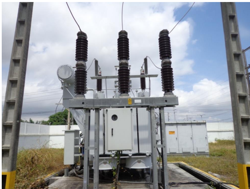
Figura 1.7 Interruptor 72,5 KV marca ABB tipo EDF SK 1-1
