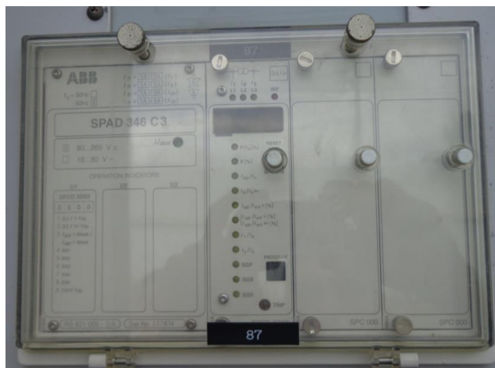
Figura 1.15 Relé Diferencia (87) marca ABB
