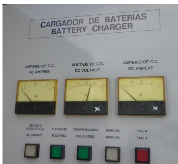
Figura 1.13 Panel del Cargador de Baterías
