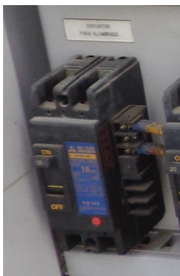
Figura 1.14 Disyuntor de servicios auxiliares
