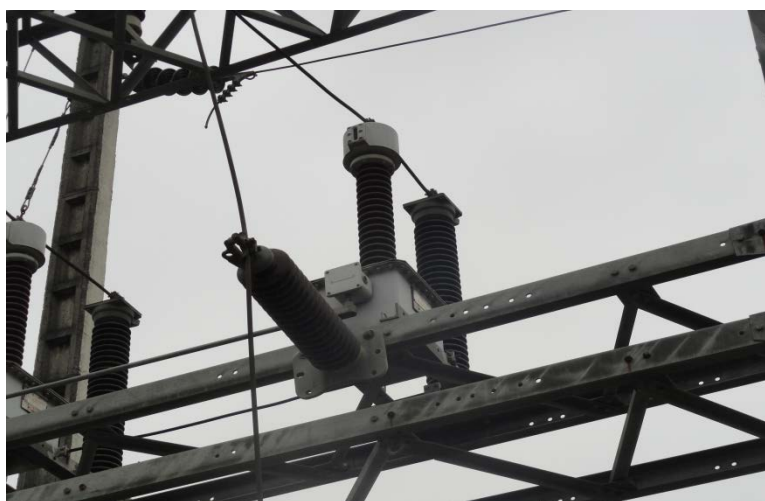
Figura 1.8 Seccionadores de aire con cuchillas de tierra
