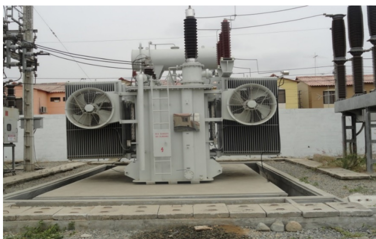
Figura 1.9 Transformador de potencia 24/30 MVA
