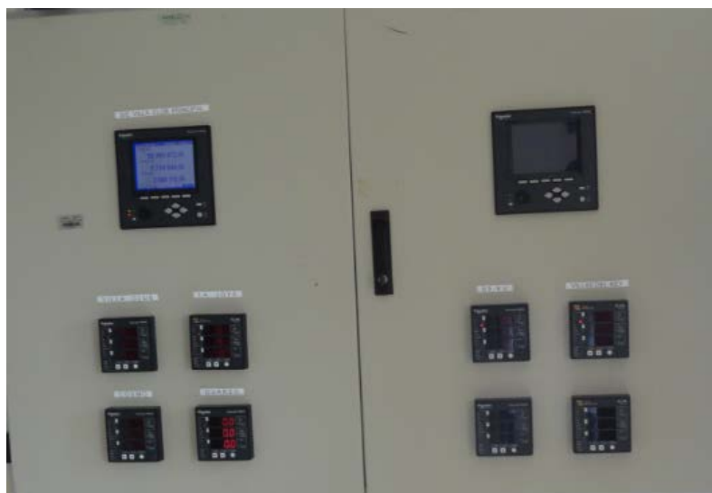
Figura 1.13 Medidores Schneider de la S/E Villa Club
