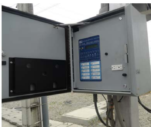
Figura 1.11 Vista del controlador tipo SEL-351R.
