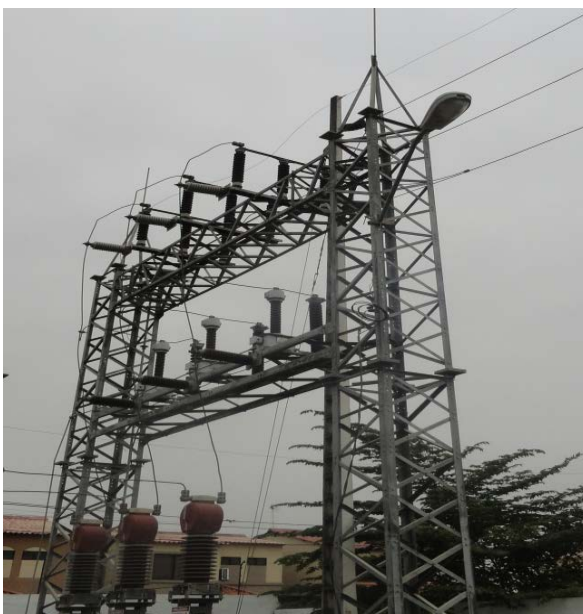
Figura 1.7 Vista de la estructura de 69 Kv
