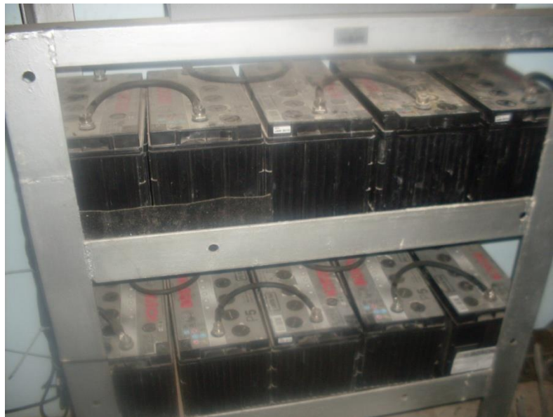
Figura 1.19 Banco de Batería
