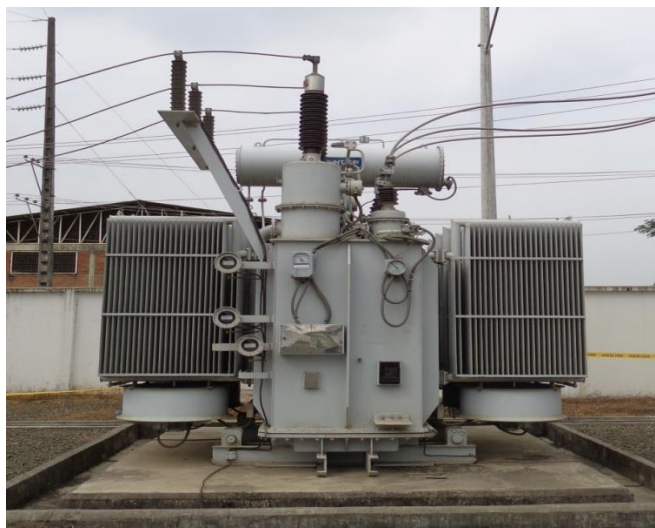
Figura 1.7 Transformador de potencia -Terminal Terrestre
