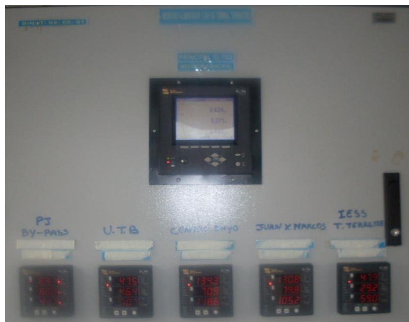
Figura 1.15 Medidor polifuncional de la subestación Terminal Terrestre
