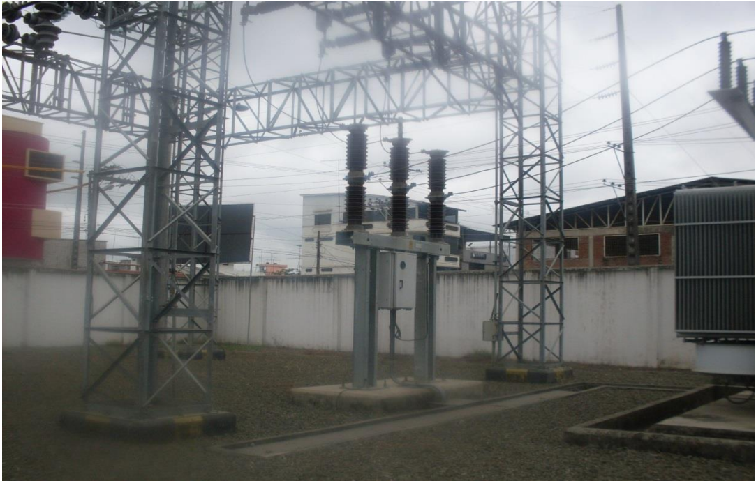
Figura 1.3 Patio de 69KV
