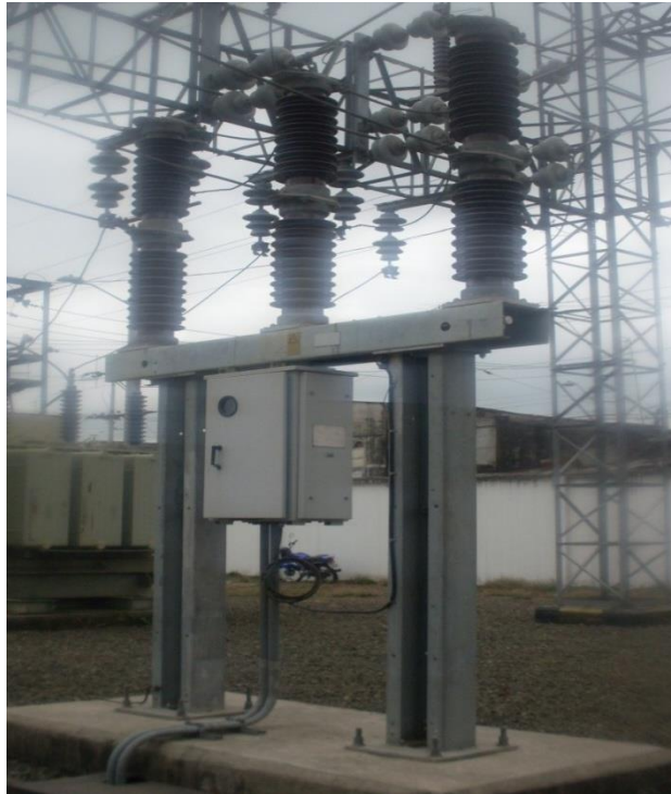
Figura 1.6 Interruptor en gas (SF6) a 72.5 KV
