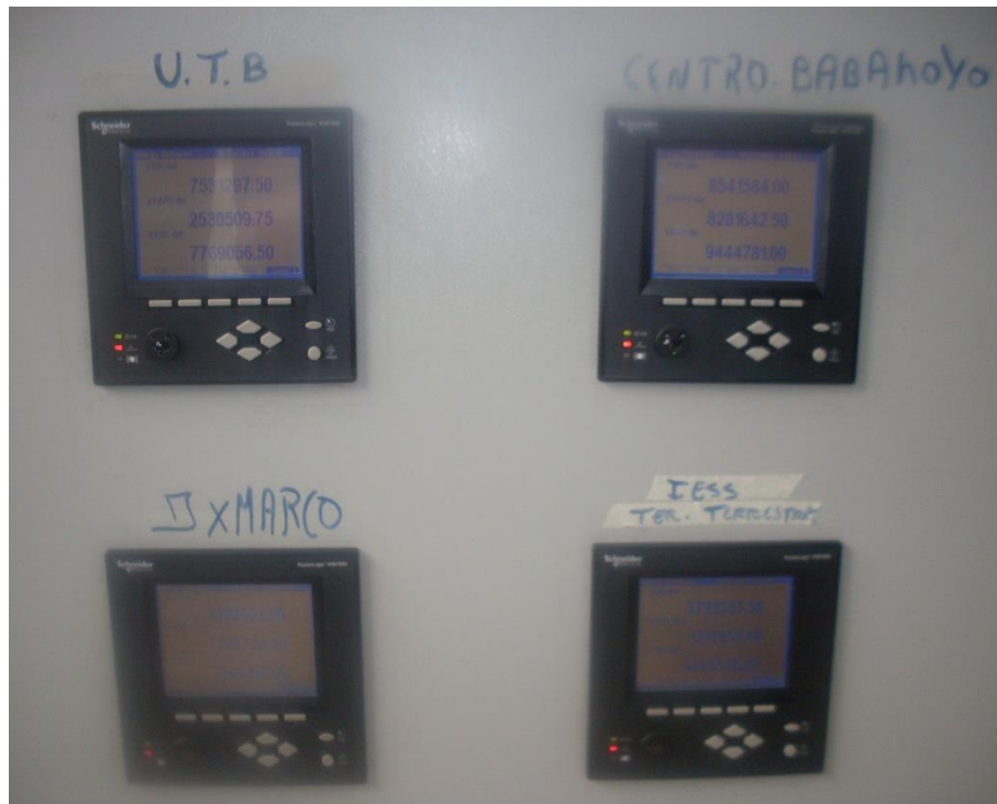
Figura 1.16 Medidores de las 4 alimentadoras de la subestación
