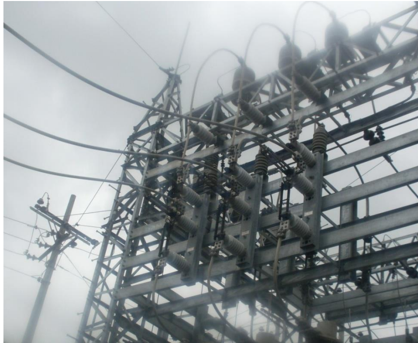
Figura 1.10 Seccionador Monopolar a 13.8 KV
