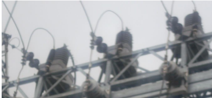
Figura 1.13 Transformadores de Potencial del Patio de 13.8 KV
