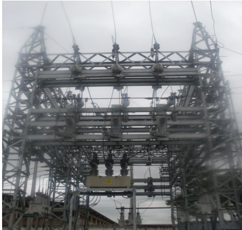
Figura 1.9 Patio de 13.8 KV
