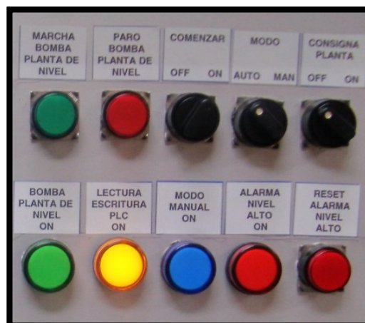
Figura 3.17 Selectores, pulsadores y luces piloto de la Planta de Nivel
