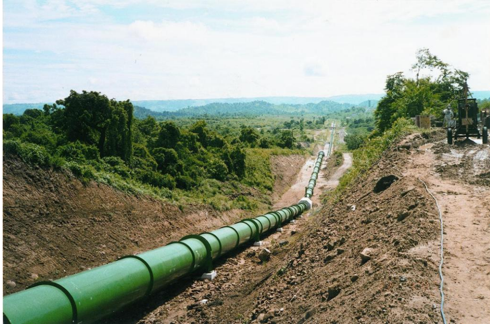
Fotografía 4: Tubería de impulsión de Estación Bombeo Chongón Fuente: CEDEX
