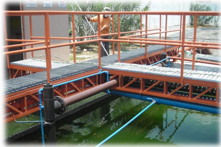
Figura 11: Foto de Clarificador de sistema de Lodos Activos (CONSULAMBIENTE, 2010).
