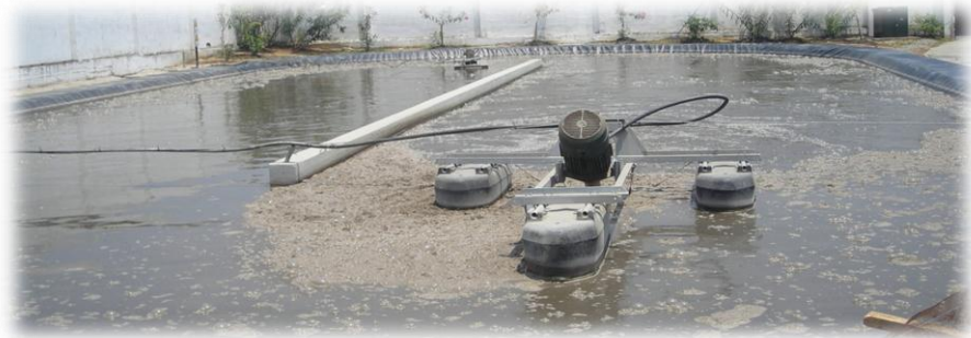
Figura 8: Foto de Sistema de Lodos Activos, Zanja de Oxidación (CONSULAMBIENTE, 2010).
