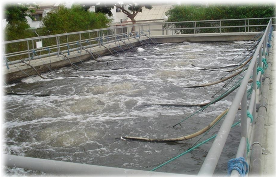
Figura 10: Foto de Tanques de Aireación de sistema de Lodos Activos (CONSULAMBIENTE, 2010).
