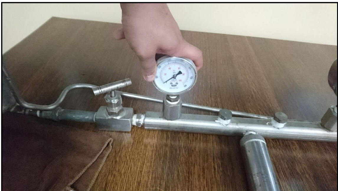
Imagen 4.-Tubería flexible de retorno, válvula de paso, manómetro a calibrar equipo final.
