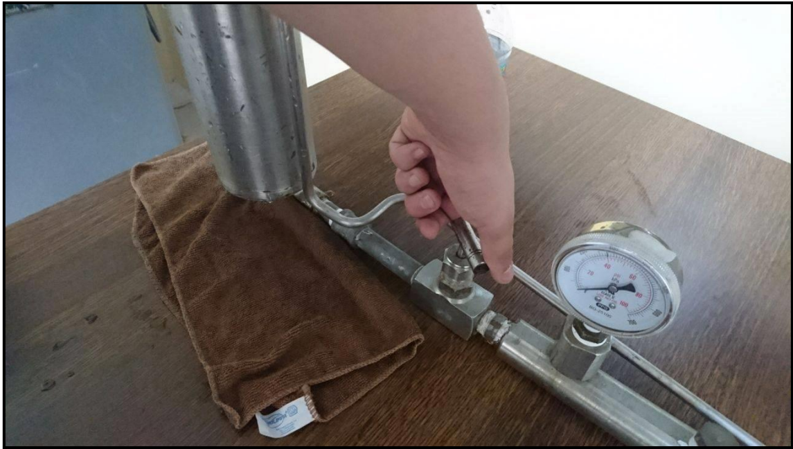
Imagen 3.-Válvulas de paso al ingreso sistema, tanque de alimentación.
