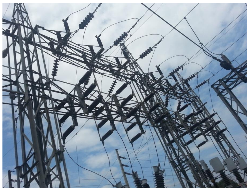
Figura 1.5 Estructura de 69 KV de la subestación Machala.
