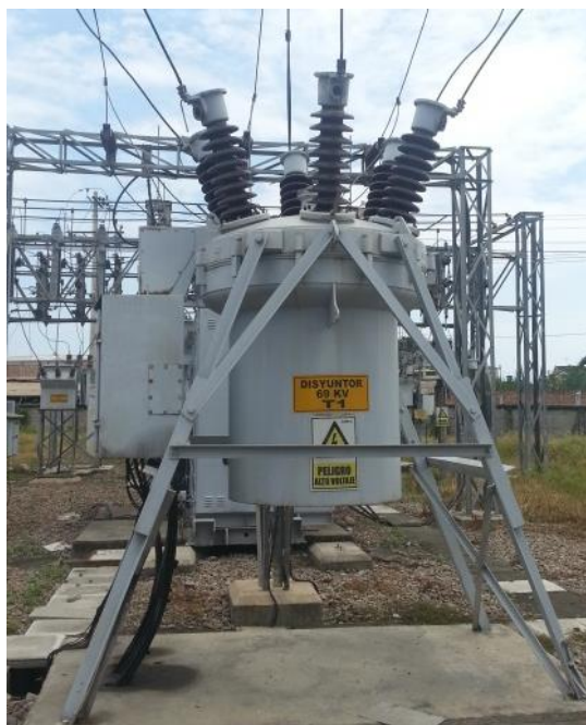
Figura 1.7 Interruptor de 69 KV de la subestación Machala.
