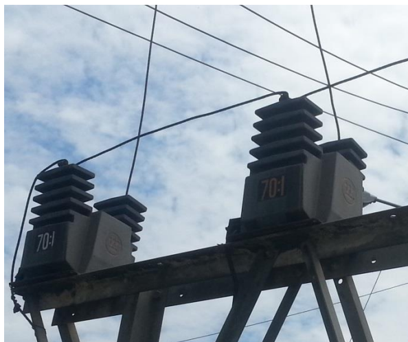
Figura 1.17 Transformador de voltaje marca Westinghouse, relación 70:1
