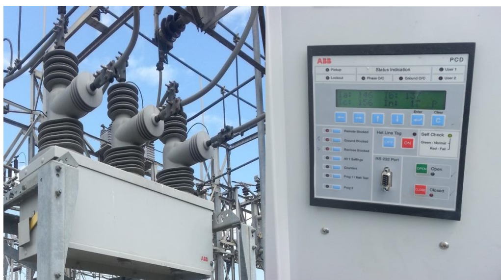
Figura 1.14 Vista del reconectador ABB con su respectivo controlador
