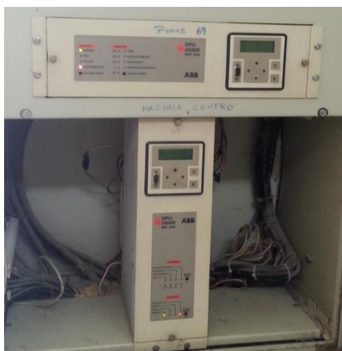
Figura 1.24 Panel de control con los relés DPU 2000R
