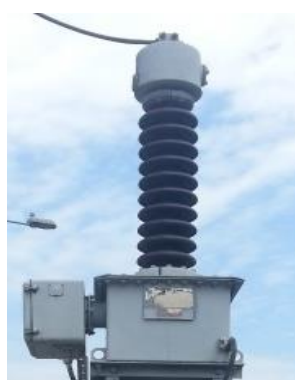
Figura 1.9 Transformador de voltaje para 69 KV
