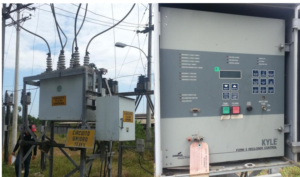
Figura 1.13 Vista del reconectador Cooper con su respectivo controlador
