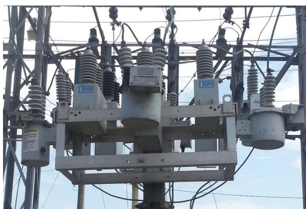
Figura 1.19 Banco de Capacitores ubicados en la barra de 13,8 KV.
