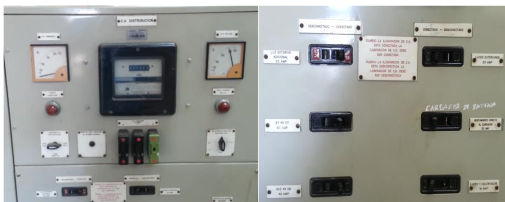
Figura 1.22 Panel con los dispositivos de medición y protección A.C. y D.C.
