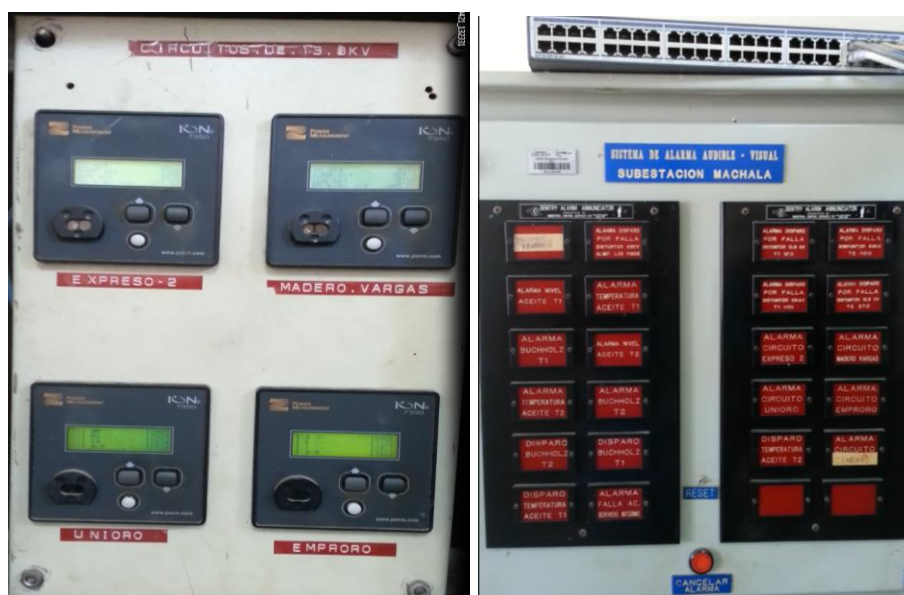
Figura 1.23 Medidores ION 7350 y panel de alarma en la S.E. Machala
