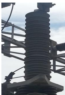
Figura 1.8 Pararrayo de 69 KV, Subestación Machala
