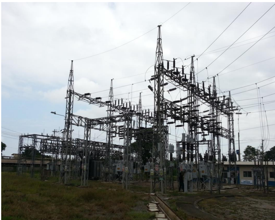
Figura 1.2 Subestación Eléctrica Machala.
