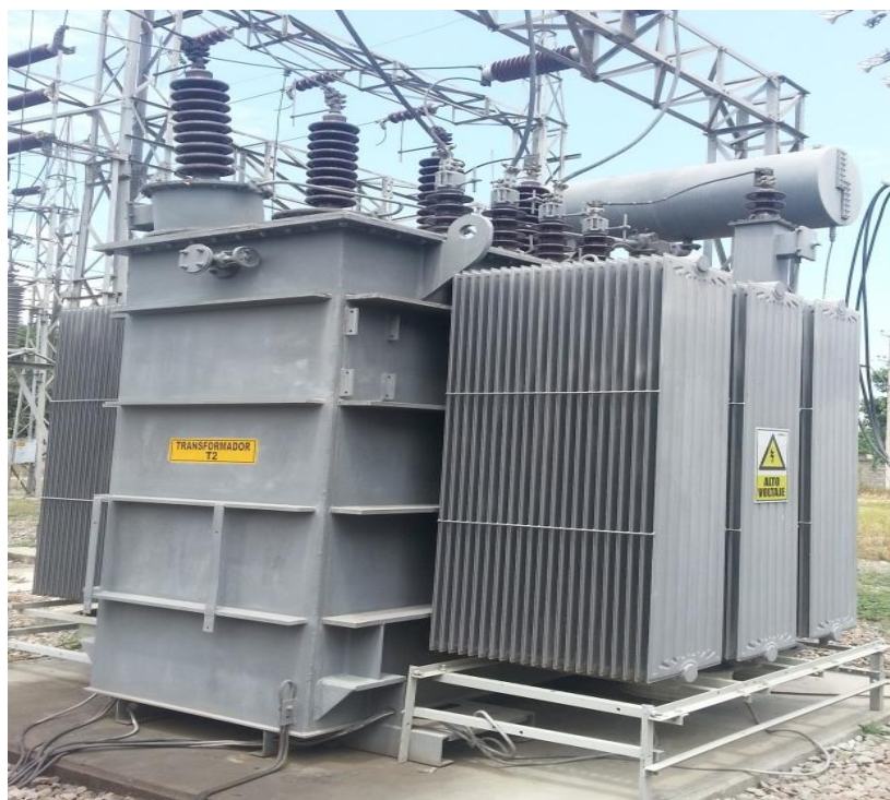
Figura 1.11 Transformador de Potencia T2 Brush S.E. Machala
