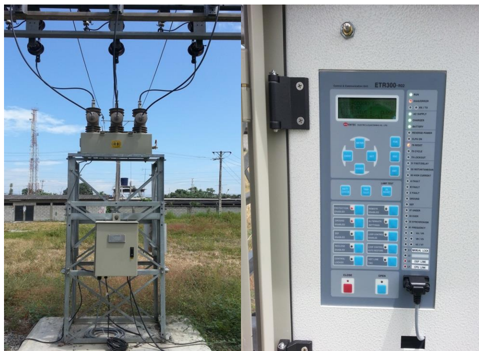
Figura 1.15 Vista del reconnector ENTEC con su respectivo controlador
