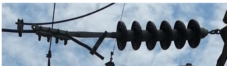
Figura 1.6 Aisladores de 69 KV, Subestación Machala
