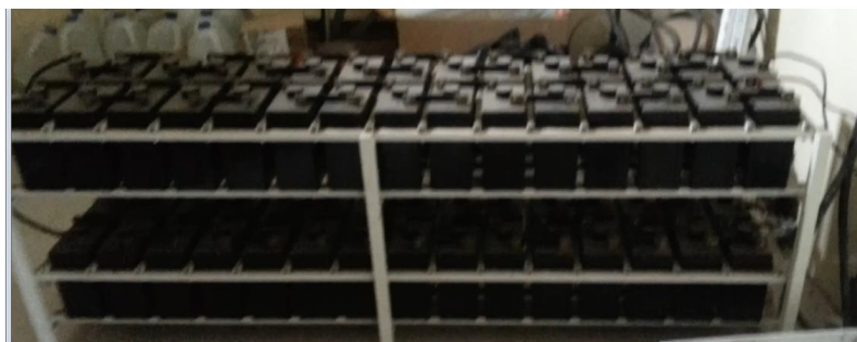
Figura 1.20 Banco de baterías
