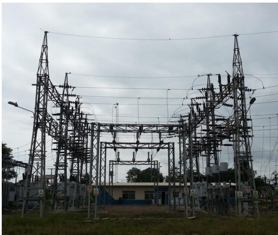
Figura 1.3 Patio de maniobras a 69 KV de la subestación Machala.
