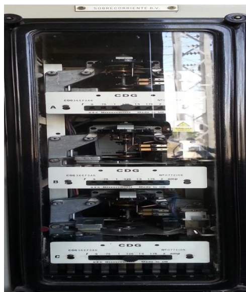
Figura 1. 25 Relé de sobrecorriente marca G.E. en bajo voltaje para T1
