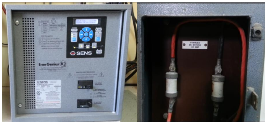
Figura 1.21 Cargador y fusibles de protección del banco de baterías
