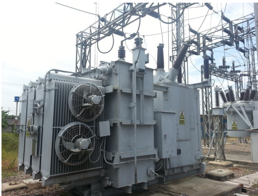
Figura 1.10 Transformador de Potencia T1 Mitsubishi S.E. Machala
