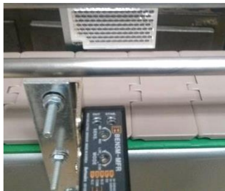
Fig. 7.7. Sensor fotoeléctrico y reflector.
