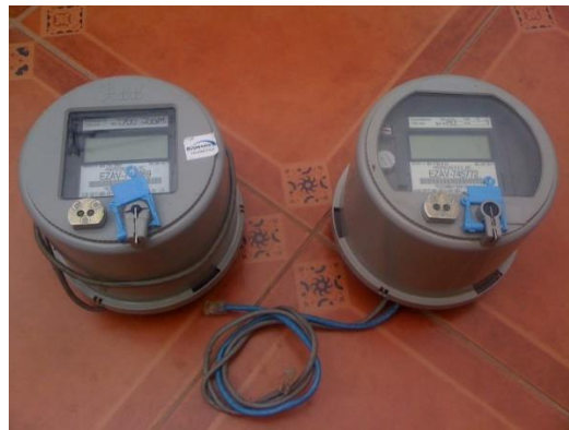
FIGURA 4.3. MEDIDORES CON TELEMETRÍA Elaborado por: Eddie Calderón M., 2005
