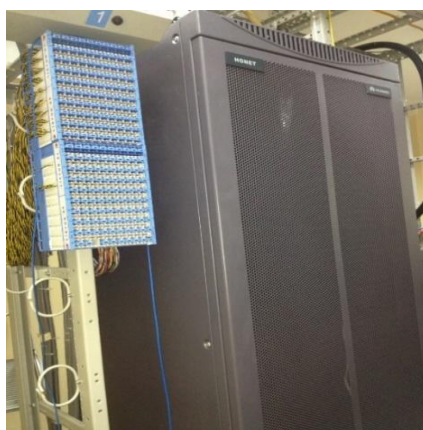
Figura 4-3 Central telefónica de la residencia [10]
