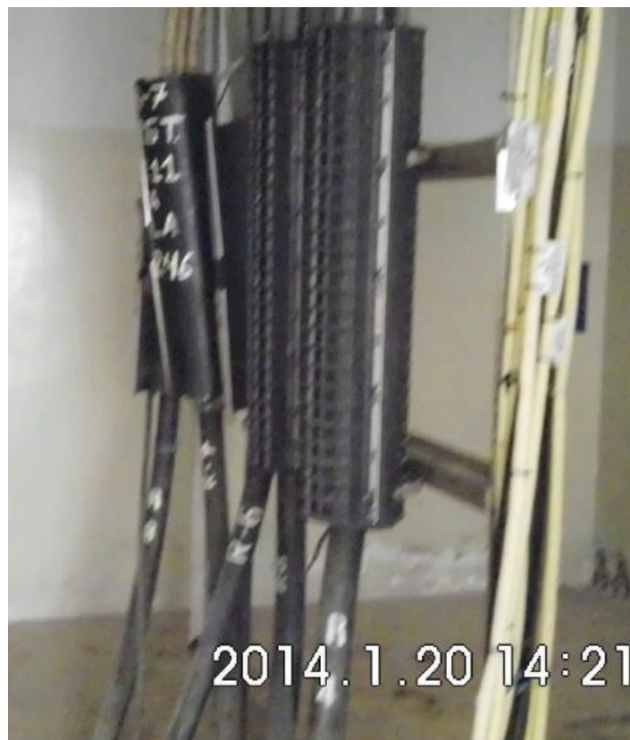
Fig. 4.4 Botellones que van hacia el sótano de cables.
