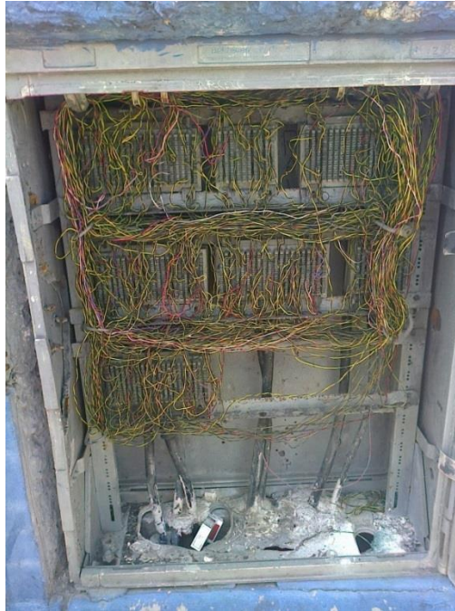
Fig. 4.5 Armario en mal estado.
