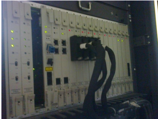
Fig. 4. 17 DSLAM Huawei – ETAPATELECOM
