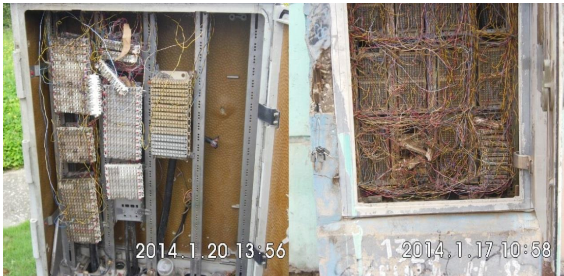
Fig. 4. 10 Armarios en mal estado.
