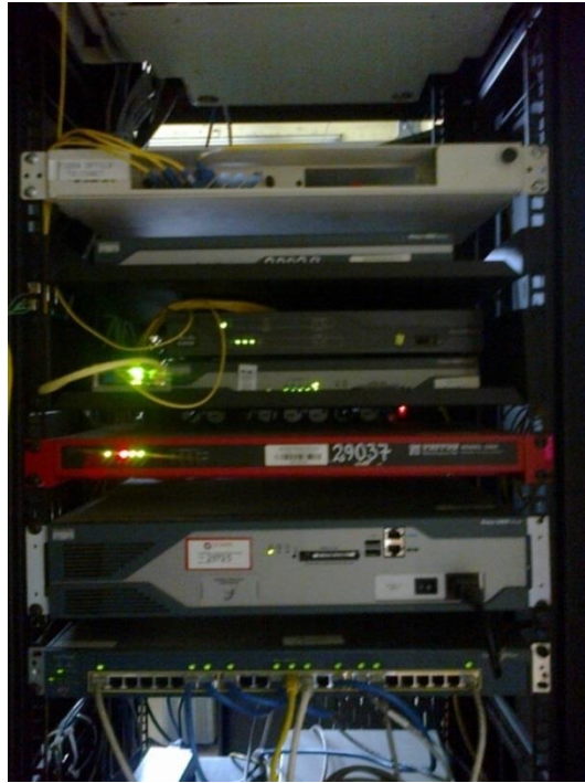
Fig. 4. 16 Rack con sus respectivos equipos de telecomunicaciones.
