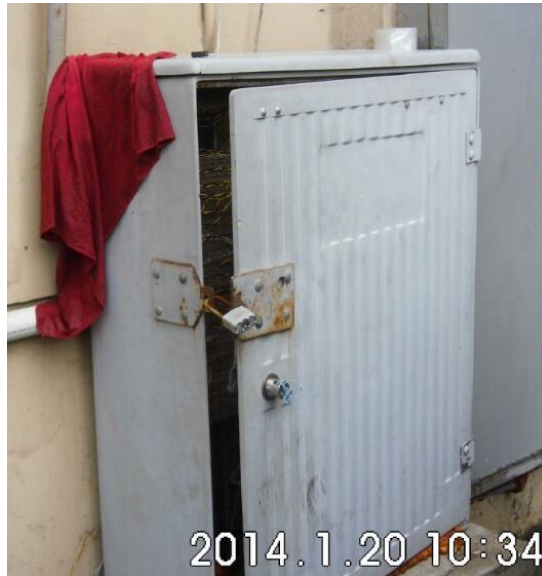
Fig. 4. 11 Armario mal cerrado.
