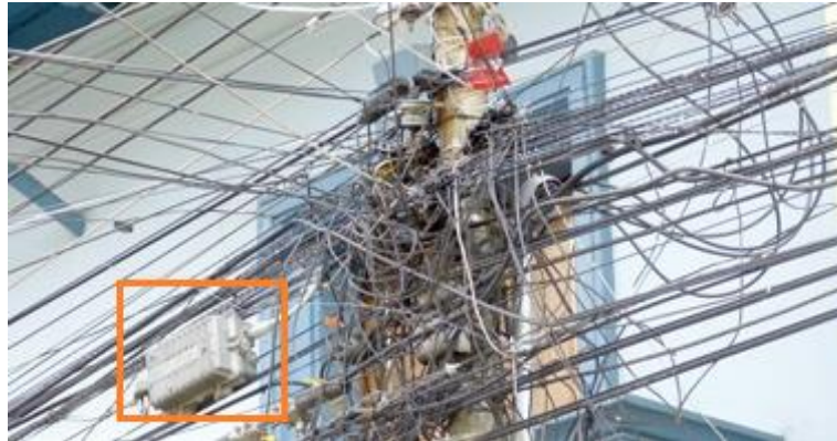
Fig. 4. 8 Caja de distribución cerca de cableado eléctrico.
