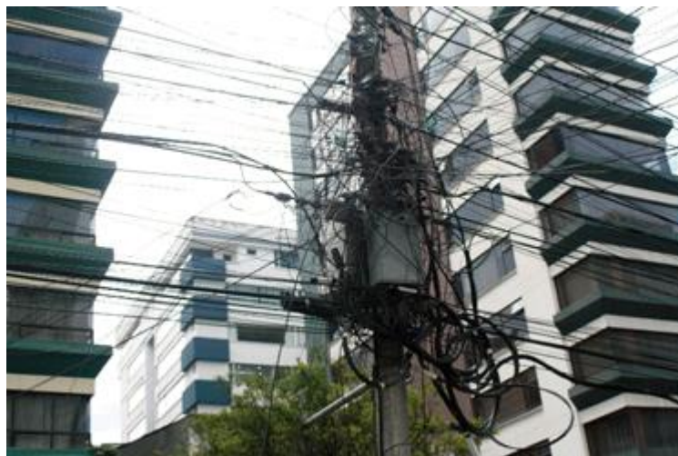
Fig. 4. 9 Cableado de datos junto a transformador eléctrico.
