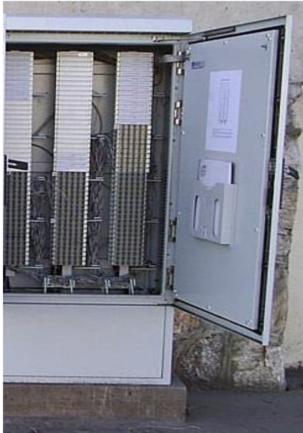
Fig. 2.15 Armario de Distribución.
